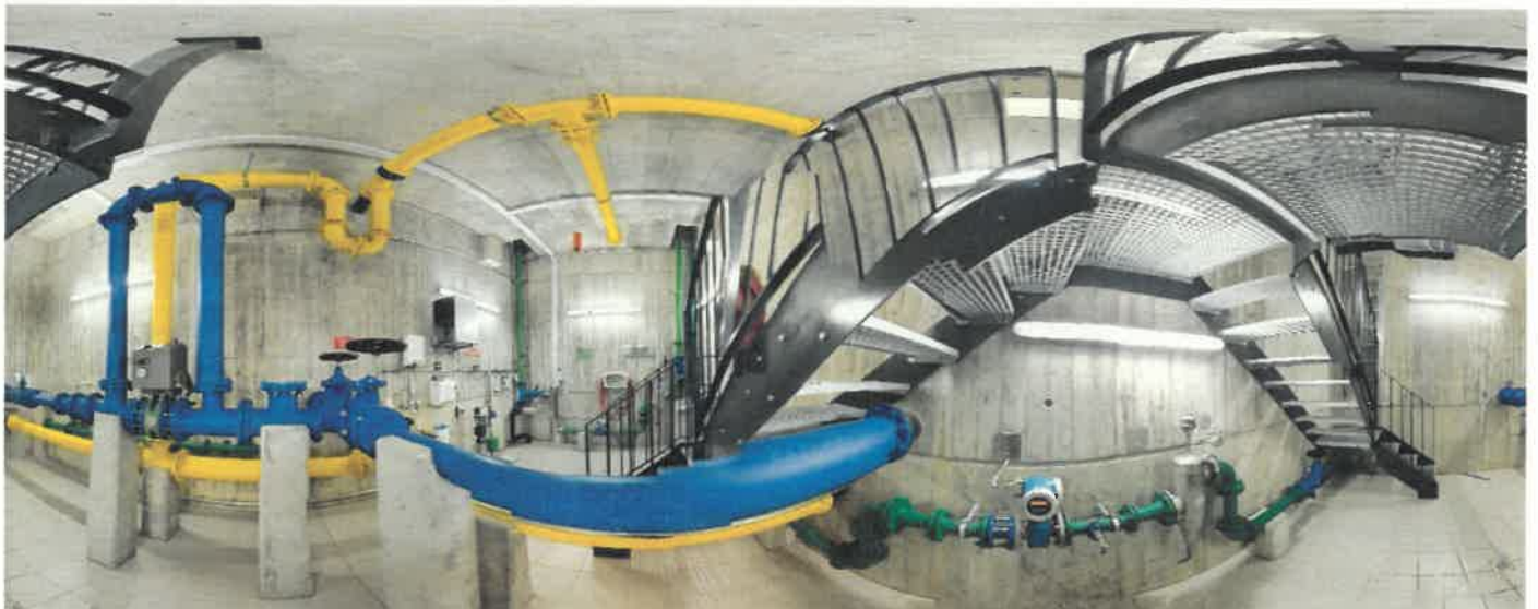
VISTA INTERNA (GRANDANGOLO!) CABINA MANOVRA SERBATOIO RONCACCIO MIGLIEGLIA (2005; 300 m3)
